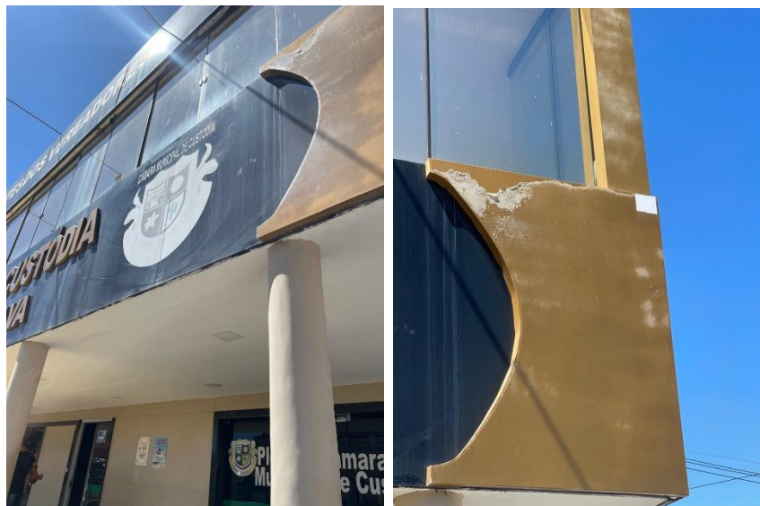
Figura 10 - Letreiros e ACM da fachada danificados
