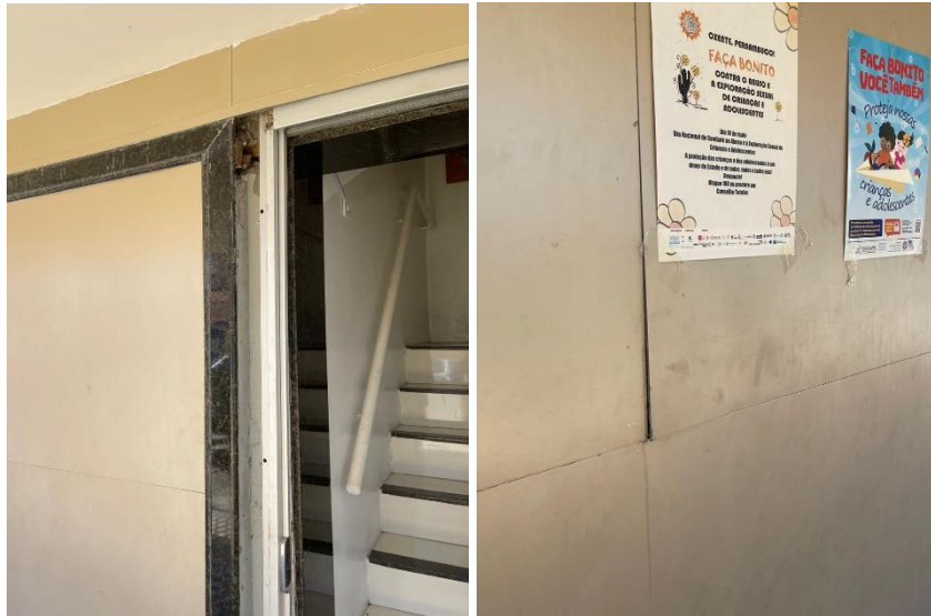
Figura 11 - ACM danificado da parte inferior
